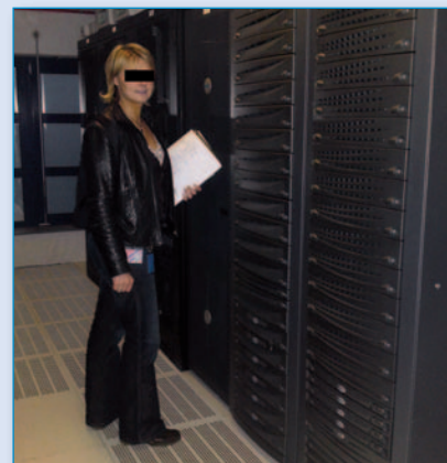
Ongeautoriseerde toegang tot de serverruimte.
